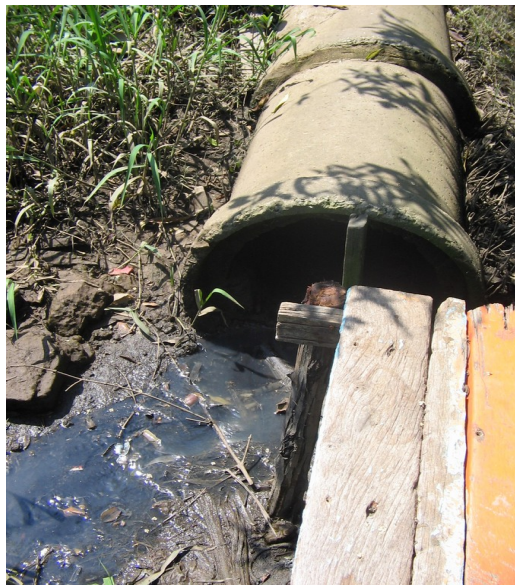
Foto1: Manilha despejando esgoto no manguezal de Gargaú Fonte: Foto da autora (2013)
